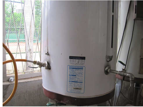
定期更換飲用水相關設備
